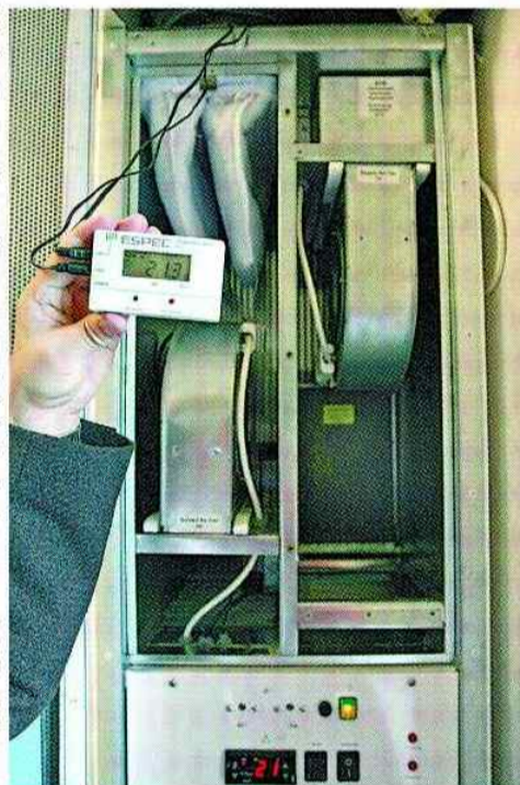
換気に使う高機能熱交換器。外気を取り入れる際に奪われる室内の空気の熱を16%に抑えるという
